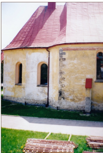
KVADROVANIE NA NÁROŽÍ POŠKODENIE V ROKU 1990
