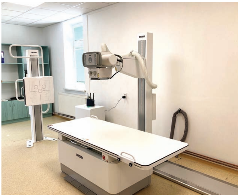
RTG: Zrekonštruované RTG pracovisko
